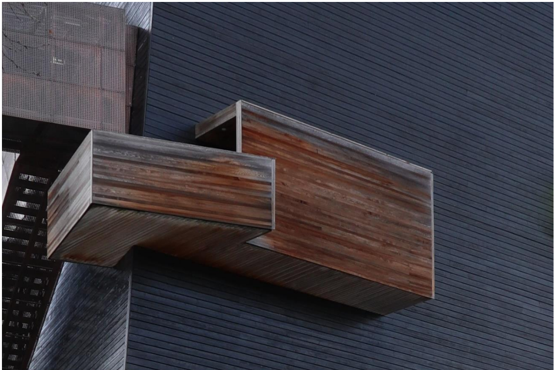
II. 207. Balkon nawiązujący do futerału na skrzypce, widok z zewnątrz. Fot. autora, 2022
