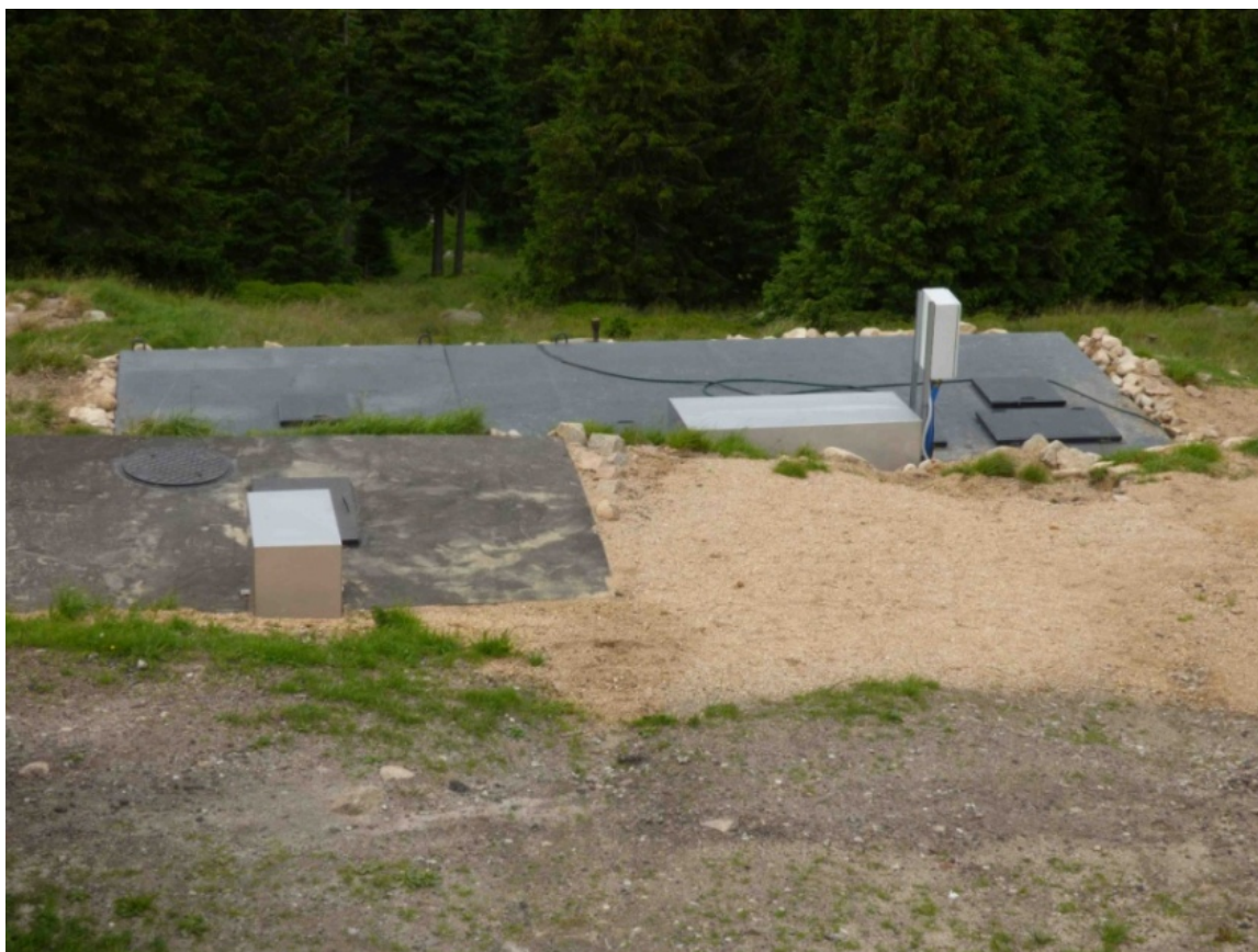
Ilu. 6.83 Oczyszczalnia Ścieków dla schroniska Strzecha Akademicka (autor: własne, 2018)
