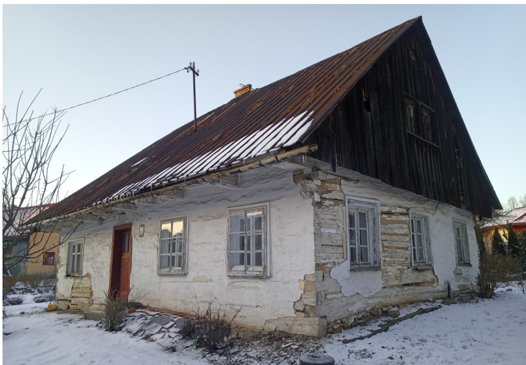
Ilu. 3.33 Budynek zrębowy w Kudowie Zdroju, od lat niepoddawany naprawom sezonowym, ale bez współczesnej ingerencji. Widoczne wyszczerbienia w izolacji między zrębami wcześniej wypełnianej gliną ze słomą. Na uwagę zasługuje oryginalna stolarka okienna (skrzynkowa) i zachowane z początku wieku szklenie (autor: własne, 2023)
