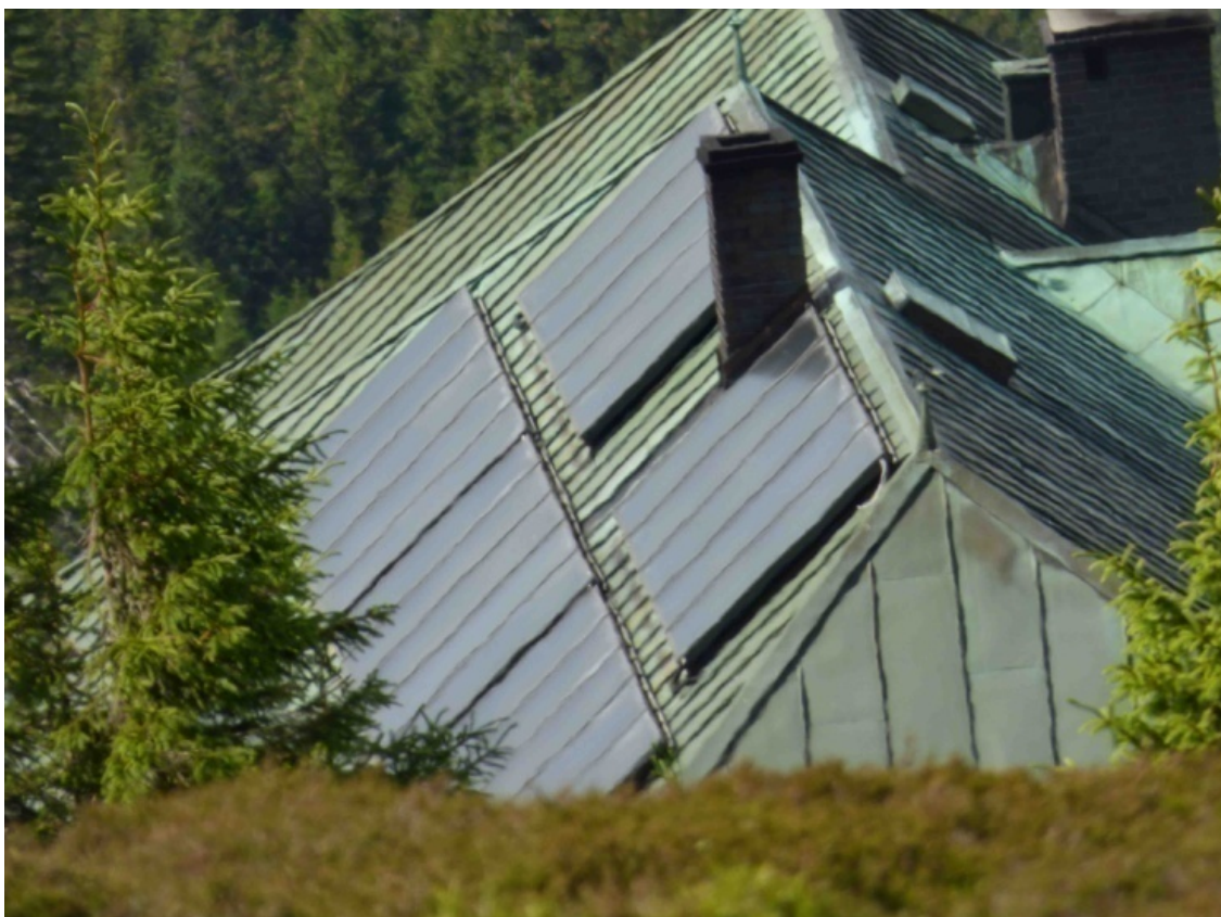
Ilu. 6.82 Kolektory słoneczne na dachu schroniska Strzecha Akademicka (autor: własne, 2018)
