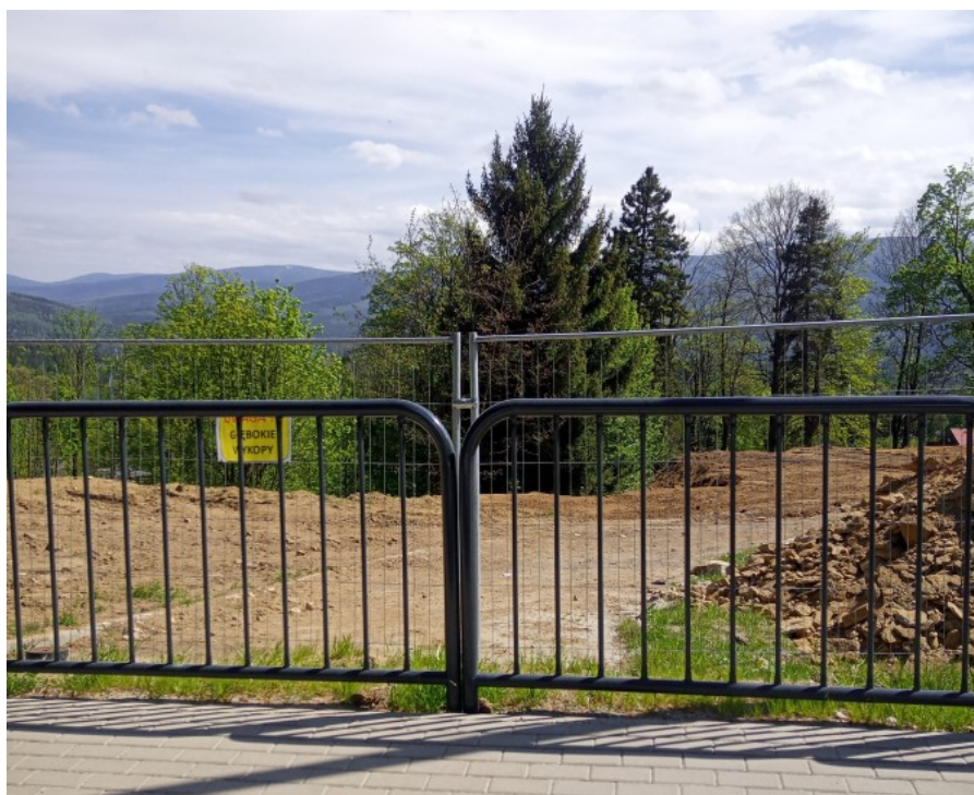
Ilu. 3.53. Miejsce po wyburzonym ośrodku Polon (autor: własne, 2024)
