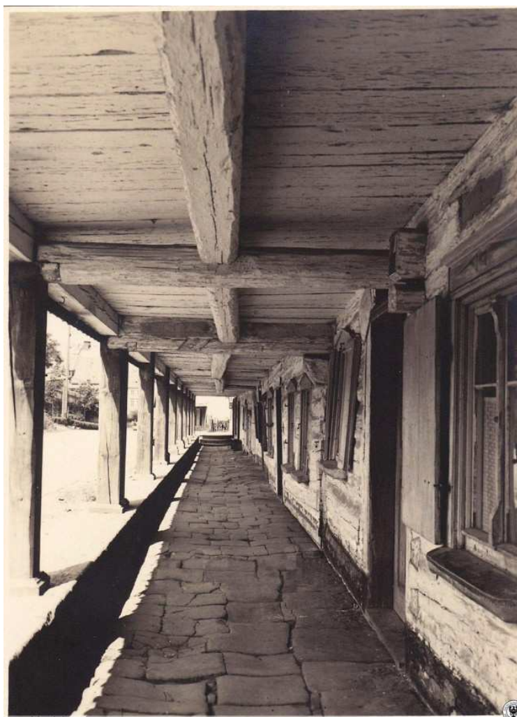
Ilu 3.20. Budynki mieszkalno–gospodarcze z warsztatami tkackimi w Chełmsku Śląskim, z podcieniami szczytowymi: zewnętrzny trakt komunikacyjny w podcieniach, stan z lat 1930–1940 (autor: nieznany, źródło: Int. 3.14)
