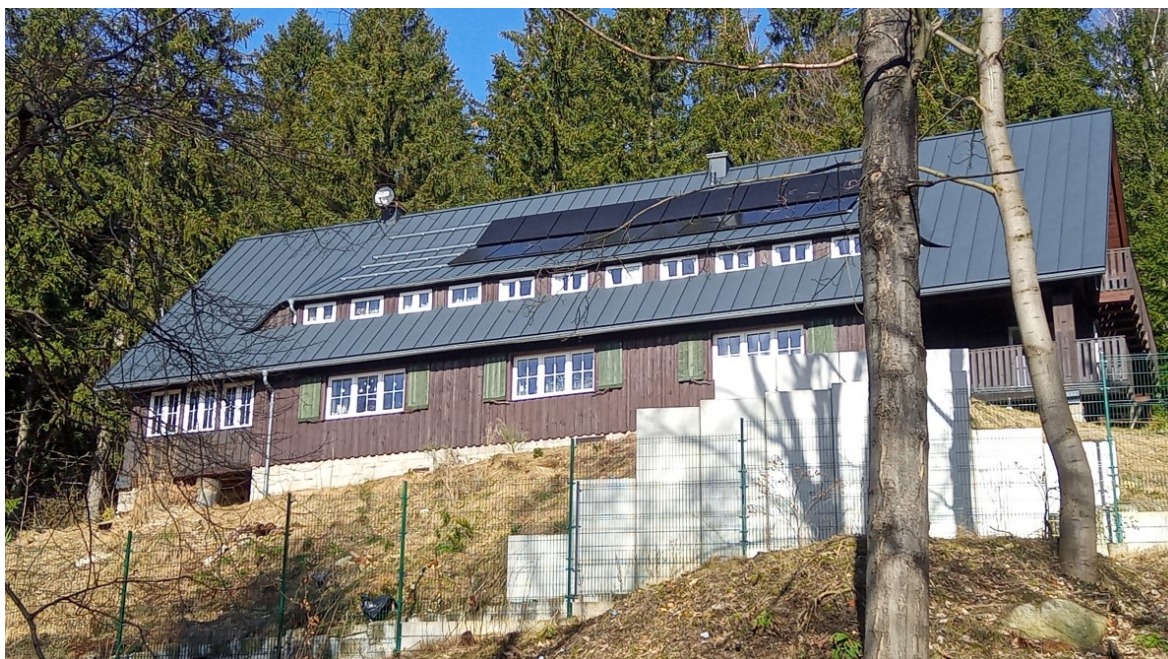
Ilu. 3.47 Panele fotowoltaiczne zainstalowane na południowej pości dachu budynku przy ul. Oficerskiej w Szklarskiej Porębie. Instalacja nawiązuje do załamania dachu lukarny. Instalacja, choć traci pod względem efektywności energetycznej (kąąt padania światła) to dobrze komponuje się z całym obiektem i nie dominuje. (autor: własne, 2024)
