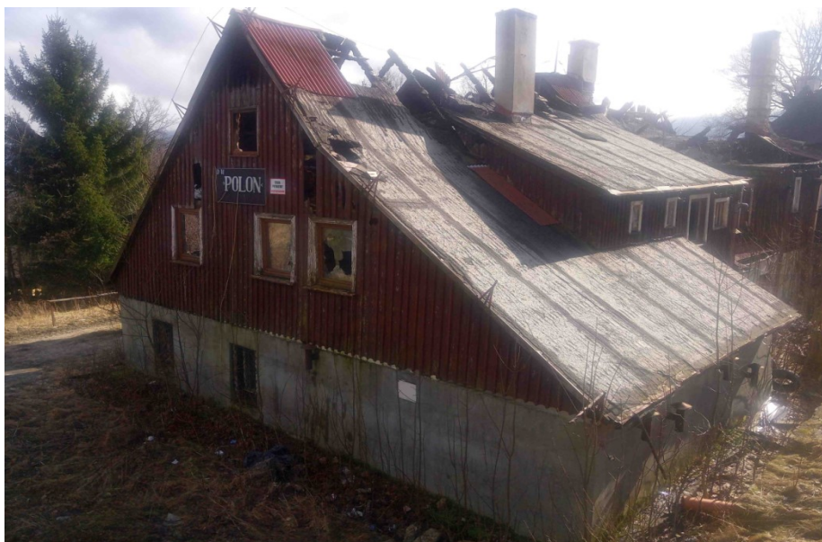
Ilu. 3.52 Ruiny, pozostawione postępującej degradacji, ośrodka Polon (autor: własne, 2024)
