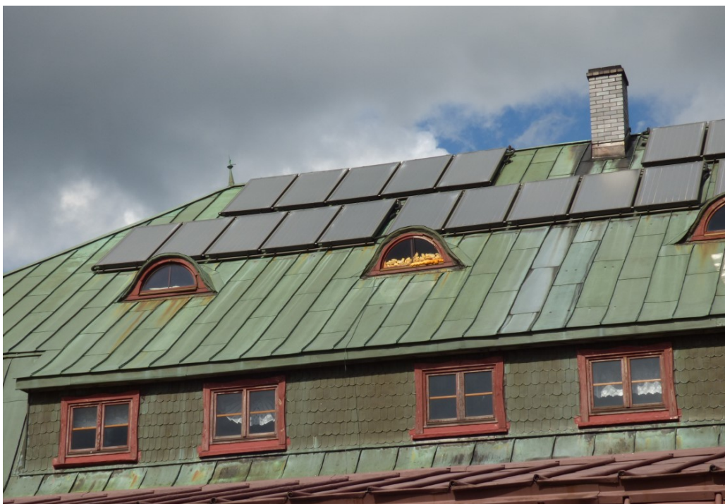
Ilu. 3.44 Panele fotowoltaiczne zainstalowane na południowo-zachodniej połaci dachu Schroniska Strzecha Akademicka. Instalacja nie nawiązuje do jakichkolwiek podziałów i pozostałych elementów budynku i dachu. Nie jest dostosowana do rozstawu rąbków blachy, rozmieszczenia względem lukarn, okien czy kominów. To przykład chaotycznej instalacji obcych elementów na istniejącej tkance zabytkowej. Również kolorystyka i montaż na szynach (nie mocowaniach punktowych) potęguje ten efekt (autor: własne, 2016)
