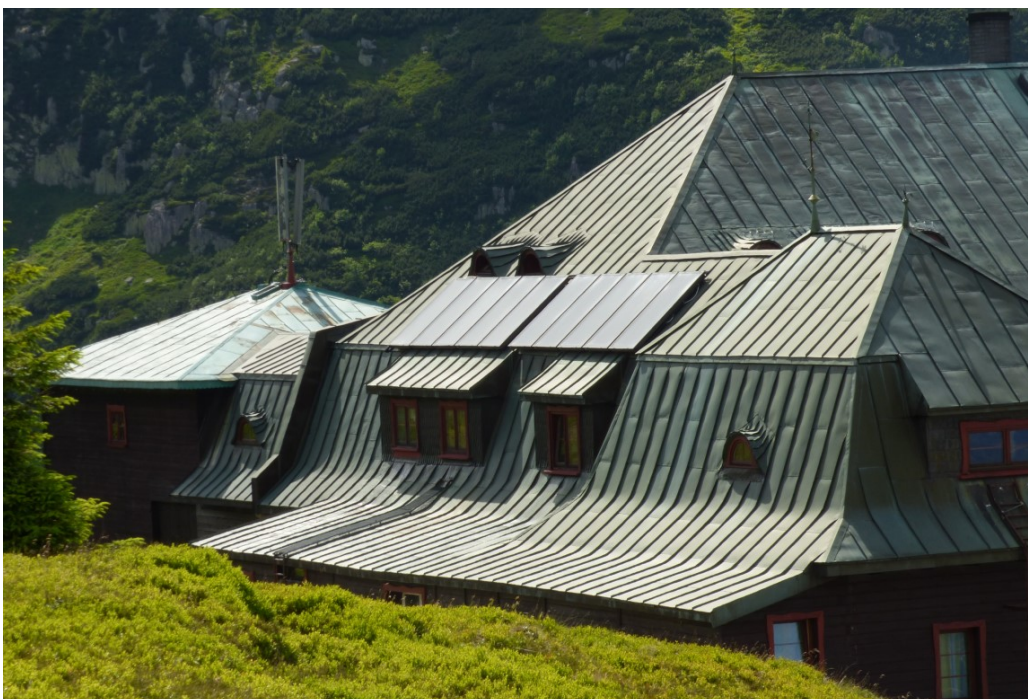
Ilu. 3.45 Panele fotowoltaiczne zainstalowane na południowo-wschodniej połaci dachu Schroniska Strzecha Akademicka. Instalacja częściowo nawiązuje do podziałów i jest dostosowana do rozmieszczenia lukarn. To przykład próby dostosowania instalacji na istniejącej tkance zabytkowej. (autor: własne, 2016)
